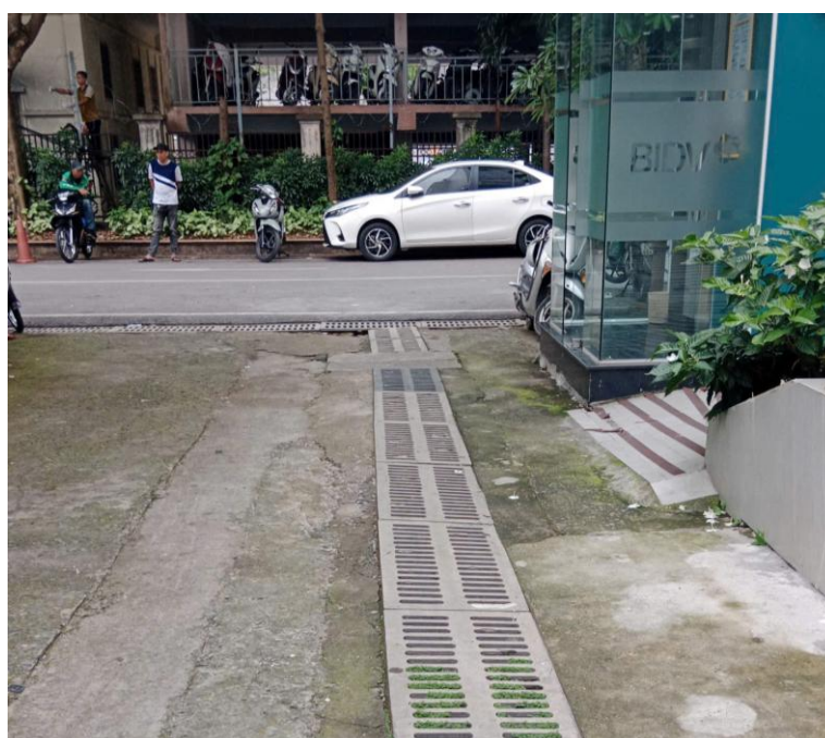
Hình 4: Hình ảnh thực tế hệ thống thoát nước mưa
