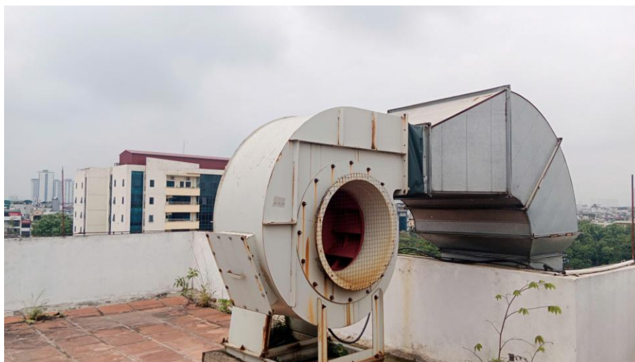
Hình 18: Hình ảnh vị trí ống khói máy phát điện Perin
